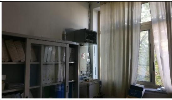
Figure 6-20 Armadio e swich LAN segreteria
