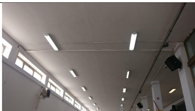
Figure 6-8 Canalina passaggio cavi laboratori piano terra a switch di piano
